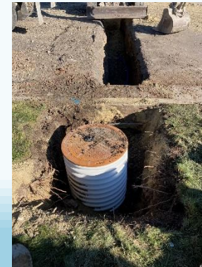
New meter box and lid
